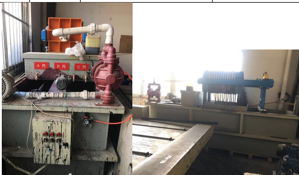
废水处理设施
